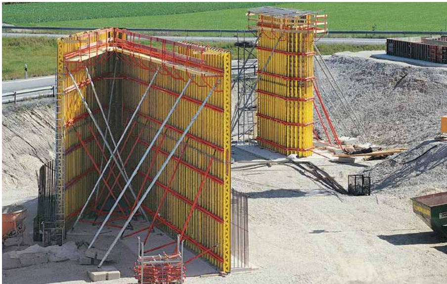
Vederlag og bropille med VARIO GT 24. Jernbanebro til den nye lufthavn i München.
