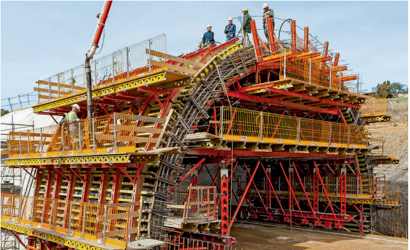
PROKIT EP 100 tilbyder beskyttelse af de frie kanter på denne tunnelforskallings arbejdsplatform.
